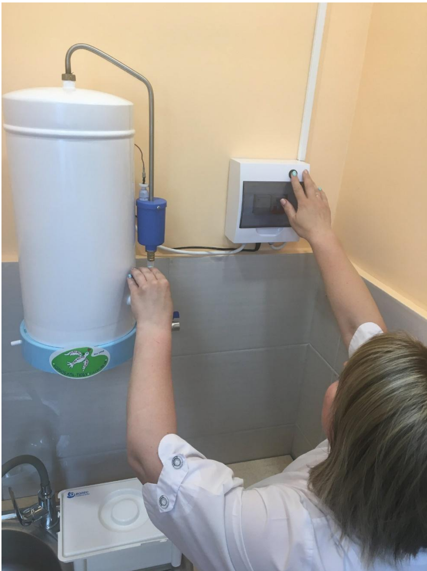
蒸留水製造装置 非常事態局医療センター
